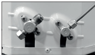
FIG. 79 - CONEXÃO DA LINHA DE EXPANSÃO DA UNIDADE CONDENSADORA
